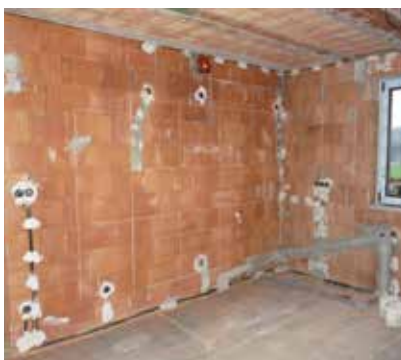
Wbudowane puszkę instalacji elektrycznej i rozprowadzone kable. Bruzdy pod instalację wodną i kanalizacyjną muszą być jak najmniejsze.
