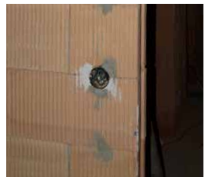
Korzystne jest użycie otworów w ceglach do rozprowadzenia kabli, np. w ściankach działowych. Zmniejsza to liczbę bruzd do wykonania.
