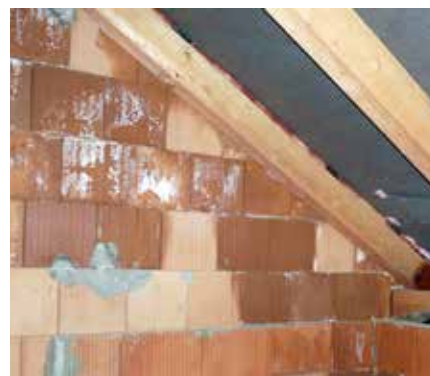
Wykwity na wilgotnym murze należy po wyschnięciu oczyścić mechanicznie.
